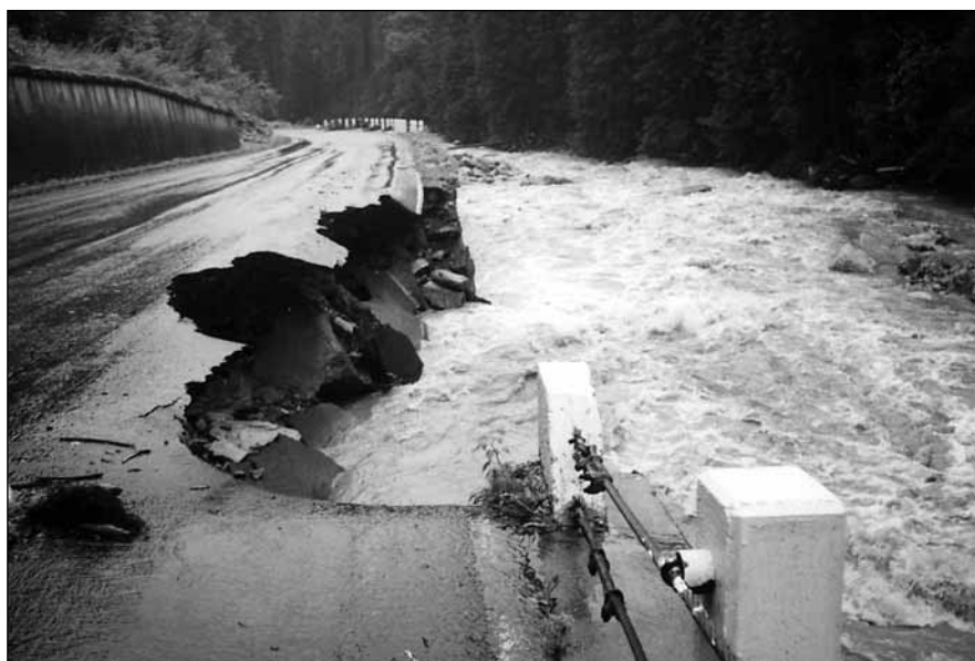
Obr. 16: Řeka se vrací zpět. Voda podemílající silnici se zastavila u opěrné zdi původní staré cesty, kterou lidé dodatečně rozšířili (státní silnice na Malé Úpě). Foto: Radko Novotný
