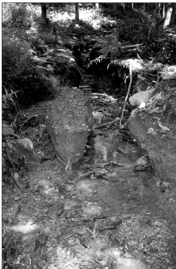
Obr. 9: Sanace erozních rýh v porostech lesů jsou stálou povinností lesního provozu. Foto: Milan Jařabáč
