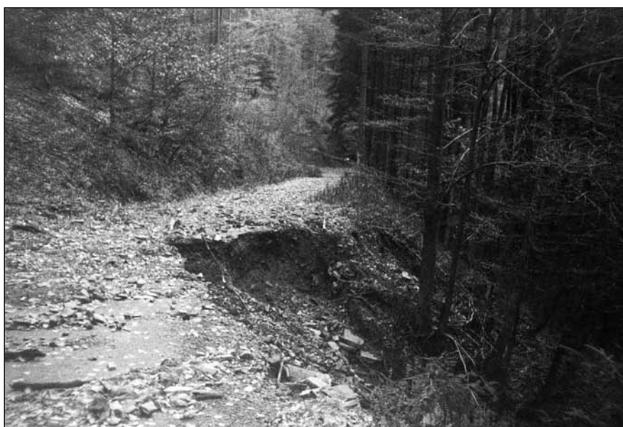
Obr. 26 Závažná poškození souběžné lesní cesty. Beskydy 1997. Foto: Jaroslav Herynek
