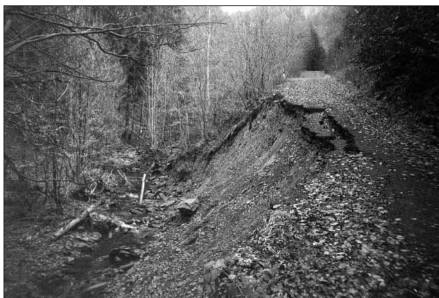
Obr. 21: Poškození lesní cesty souběžnou bystřinou. Beskydy 1997. Foto: Jaroslav Herynek
